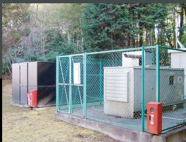
地震・災害時の為の自家発電装置
