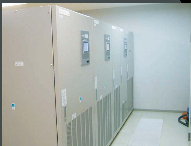
電源確保の為のUPS
