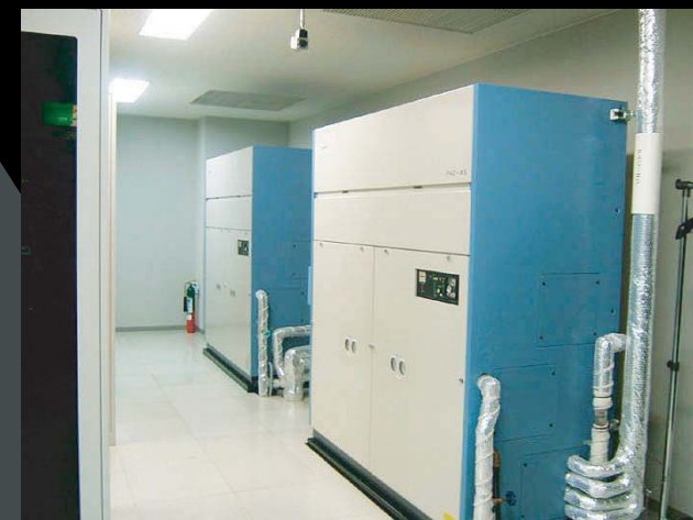
湿度・温度を保つ為の空調設備
