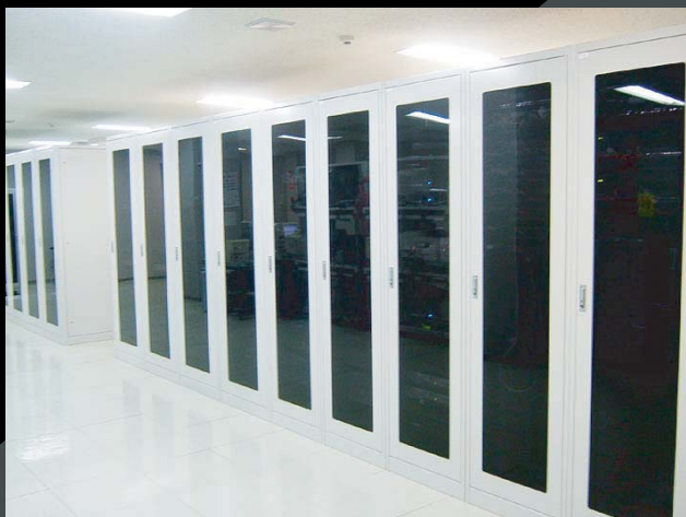
データセンター内
