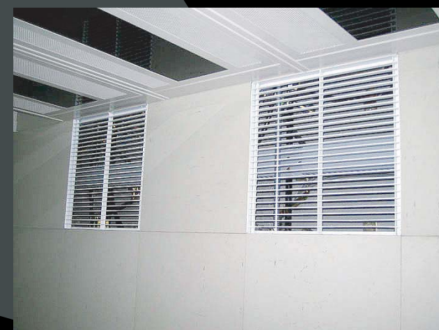
廊下・床下からも空調管理
